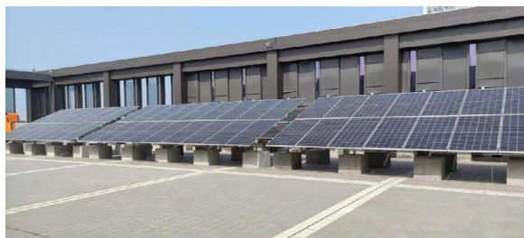
富阳二期工厂屋顶光伏
